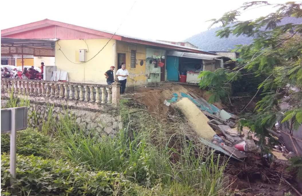
Kawasan Belakang Gerai Yang Perlu Dibersihkan dan Dibina Tembok Penahan Baharu
